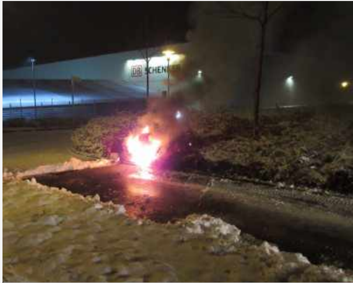
Brand Elektroverteilerkasten, Clemens-Winkler-Straße
