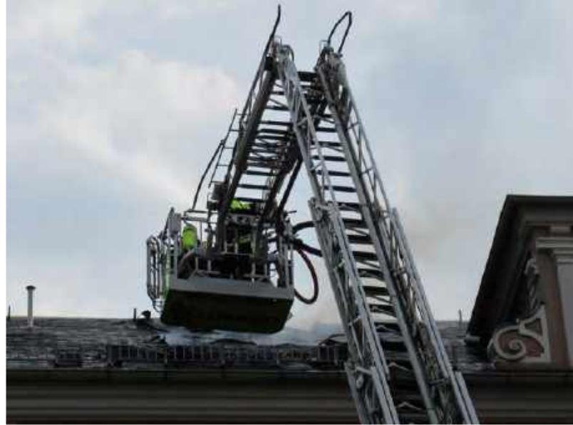
01.05.2017 – Dachstuhlbrand auf der Jägerstraße
